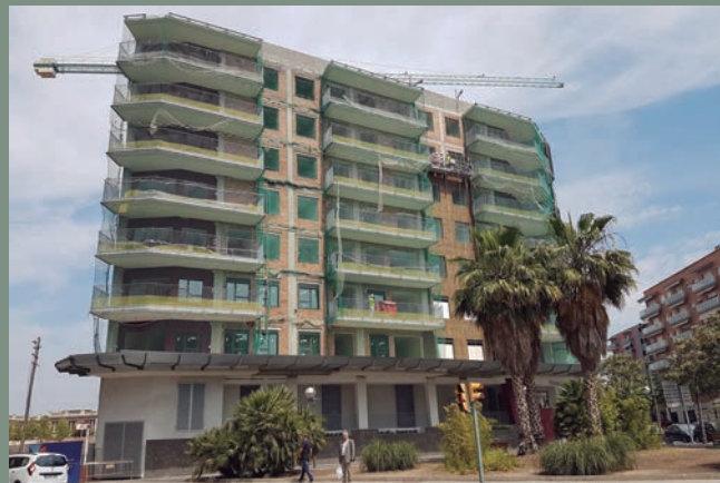
Comunitat de veïns del carrer Torres Jordi de Tarragona, en plena rehabilitació.
