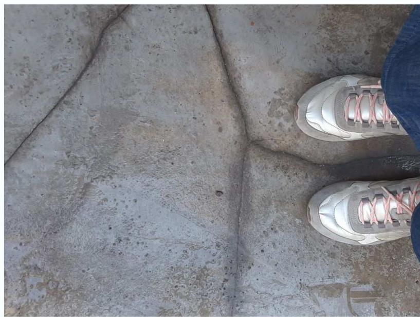
Títol: "Fissures anegades"
