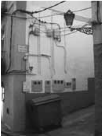
La xarxa elèctrica i la telefònica, subjectes a les façanes ofereixen un aspecte deteriorat.
