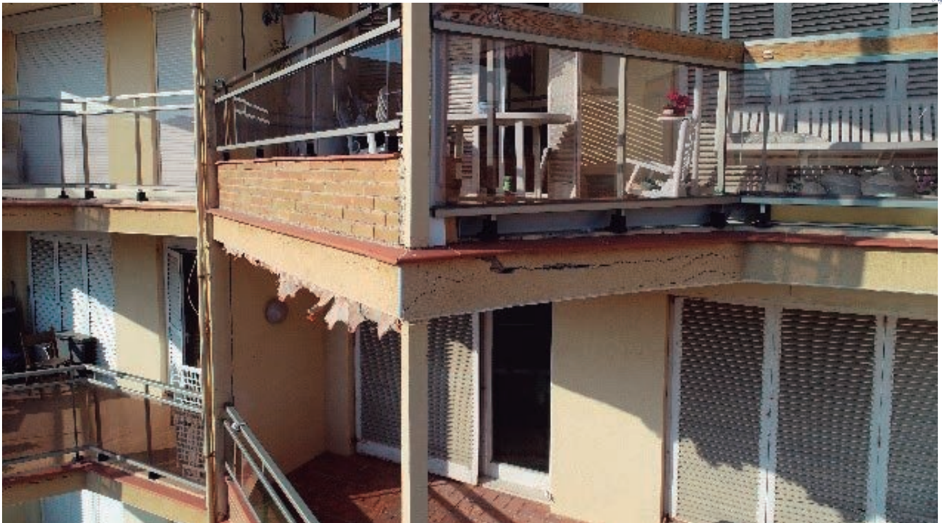
Patologies detectades en una cinquena Planta amb tecnologia dron
