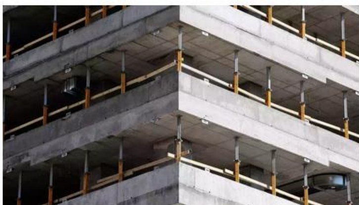
A la fase 2 ja es poden fer obres en habitatges on ja hi ha ocupants | COAATT
