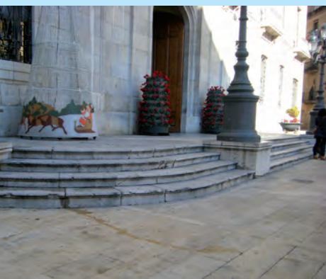
Manca de baranes, graons amb discontinuïtat entre estesa i alçada i mal estat de conservació
